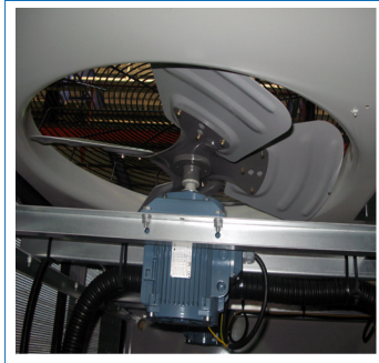
Condenser Fan Motor
